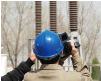
Begehung eines Umspannwerks bei laufendem Betrieb
