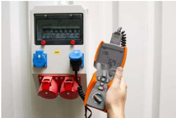
Schleifenmessung an einer Industrieverteilung mit dem AMZC-304
