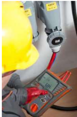
Schleifenmessung an einer 690-V-Industriesteckdose mit dem AMZC-305
