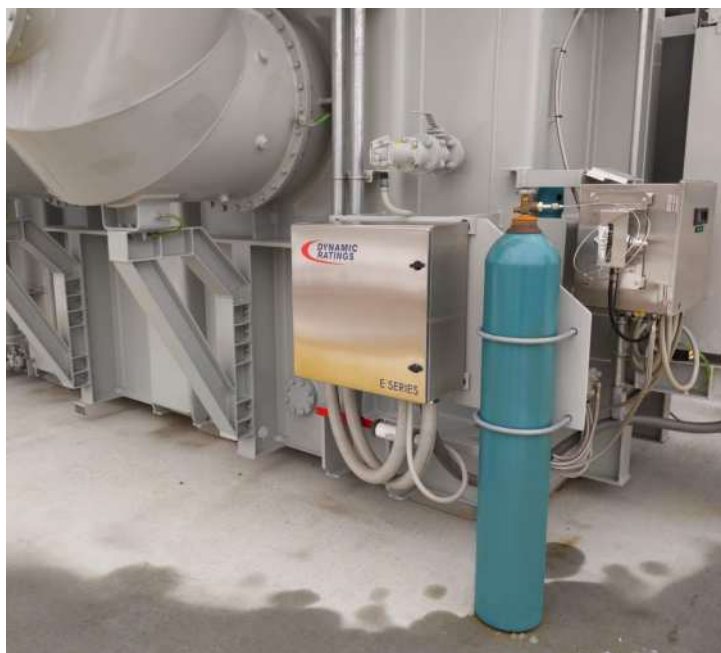
E Series installé sur un transformateur de puissance
