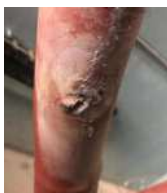
Cas réel : DP localisée sur une extrémité de câble
