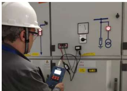
Mesure de décharges partielles dans un poste de transformation
