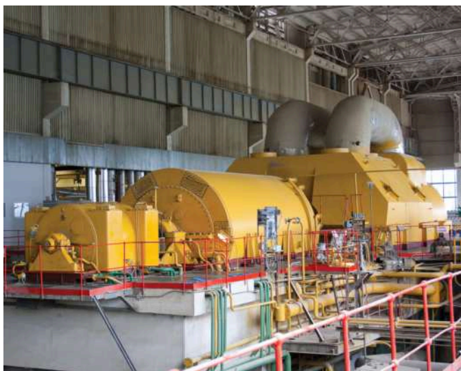
Turboalternateurs et grands moteurs : des actifs critiques surveillés
