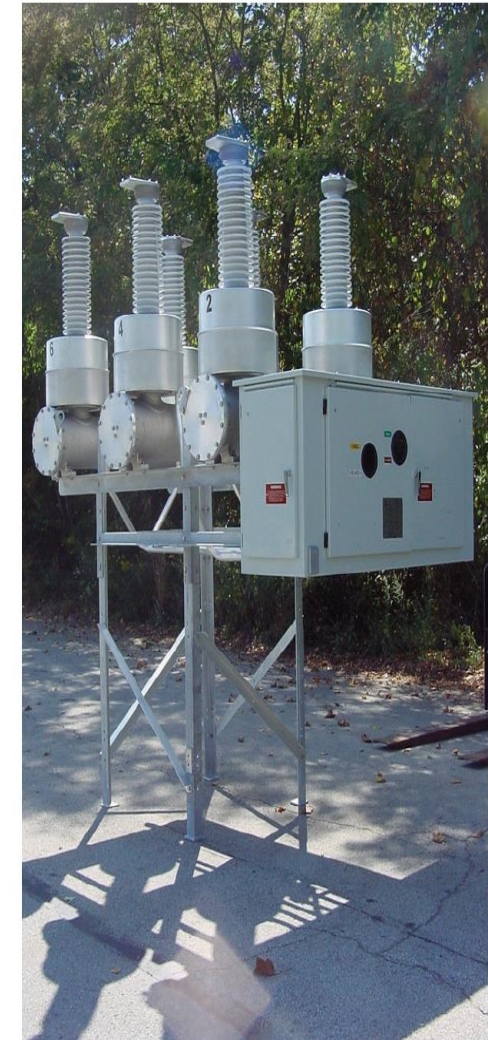
SWITCH- 72.5KV : Poids du SF6 : 13 kg
