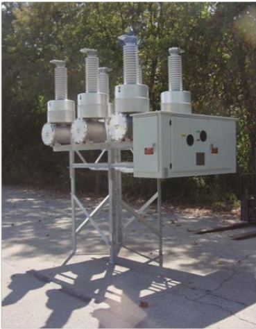
SWITCH- 72.5KV : Poids du SF6 : 13 kg
