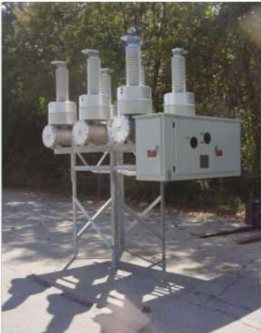
SWITCH- 72.5KV : Poids du SF6 : 13 kg
