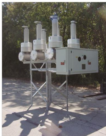
SWITCH- 72.5KV : Poids du SF6 : 13 kg
