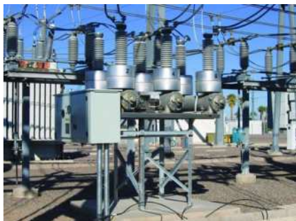
Disjoncteurs à cuve morte, une application typique
