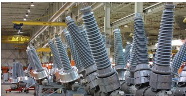
Disjoncteurs de puissance au SF6.
