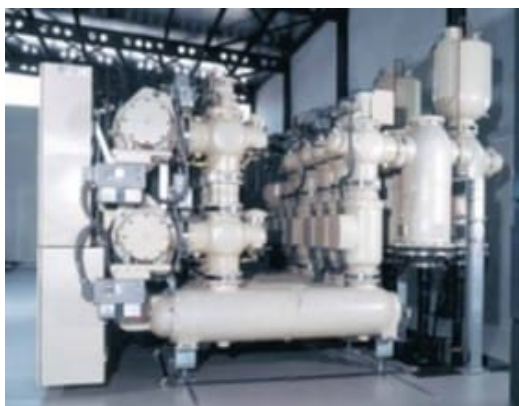
Cellules isolées au gaz, une application courante de l'AGRU-8
