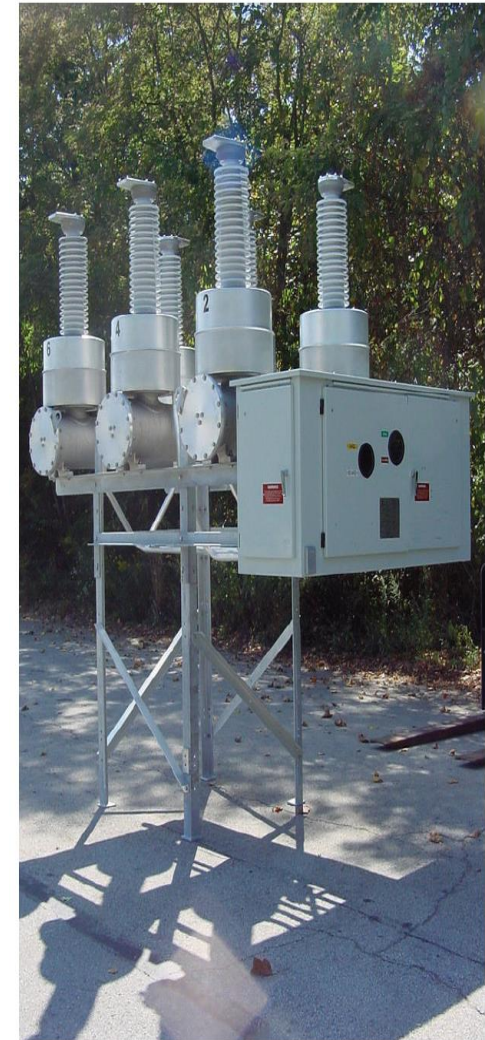
SWITCH- 72.5KV : Poids du SF6 : 13 kg
