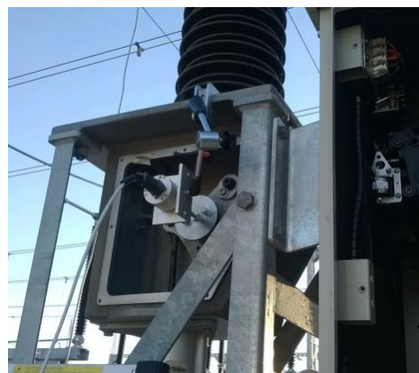
Transductor rotativo digital montado sobre interruptor automático ABB LTB 245 kV SF6
