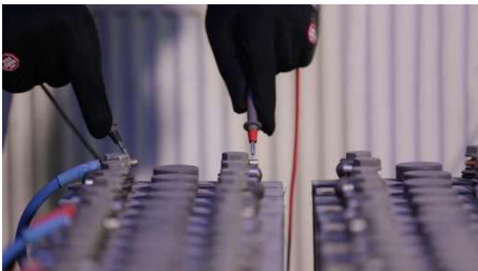
Banchi di batterie stazionarie: la destinazione abituale dello strumento
