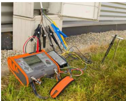
Misura della resistenza di terra con l'AMPI-525 in campo
