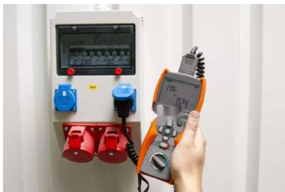
Misura dell'anello su un quadro industriale con l'AMZC-304
