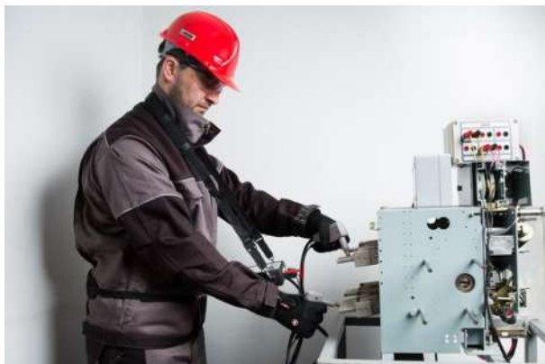
Misura della resistenza di contatto su un interruttore in sottostazione
