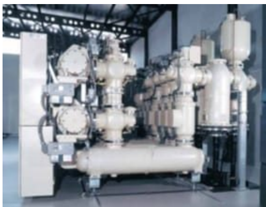
Quadri isolati in gas, un'applicazione tipica dell'AGRU-8
