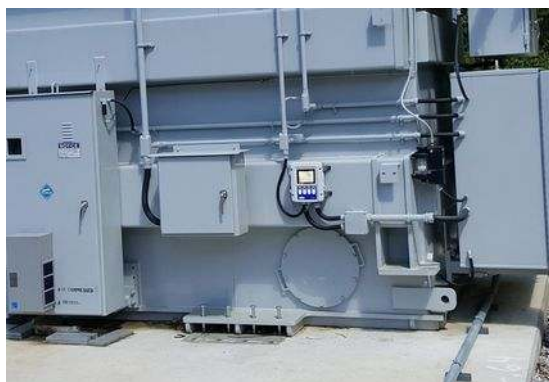
Il B100 installato in un armadio di controllo del trasformatore, accanto ad altre apparecchiature ausiliarie.
