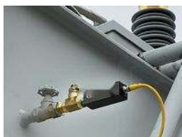
Sensore di idrogeno installato sulla valvola di campionamento dell'olio del trasformatore.
