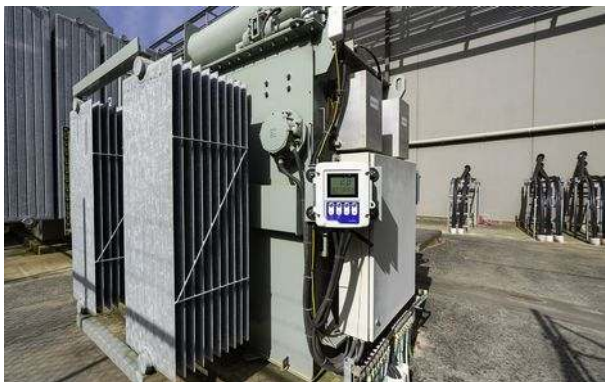
Il B100 installato su un trasformatore di distribuzione, mentre calcola in tempo reale il punto caldo e l'invecchiamento della carta isolante.
