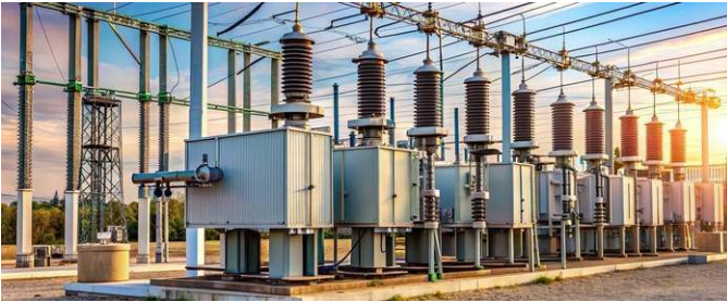
Monitoraggio permanente del parco trasformatori, senza sopralluoghi per prelevare campioni d'olio.
