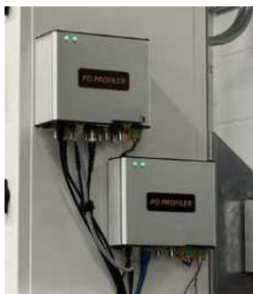
Unità in cascata in un quadro, installate senza fermo impianto
