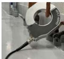
Pinza HFCT-HD sul ritorno di terra di un cavo
