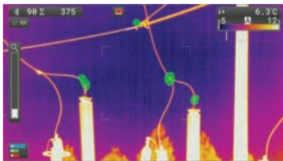
Isoterme del canale termico su una catena di isolatori
