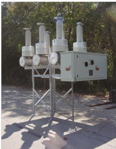
SWITCH- 72,5KV: Peso de SF6: 29lbs- 13kg
