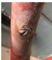
Caso real: DP localizada en una terminación de cable
