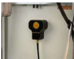
Sensor SonoTEV Pro fijado magnéticamente a una celda
