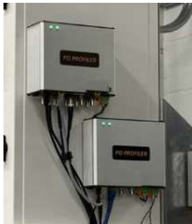
Unidades encadenadas en un armario, instaladas sin parada
