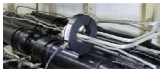
PINZAS PARA DESCARGAS PARCIALES PUESTA A TIERRA
