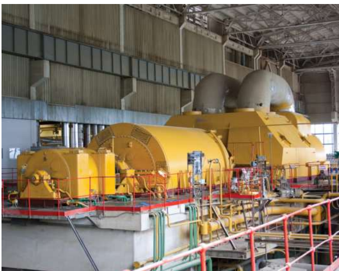
Turbogeneradores y grandes motores: activos críticos monitorizados
