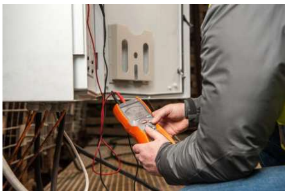
Ensayo de continuidad con el AMIC-30 en un armario de distribución
