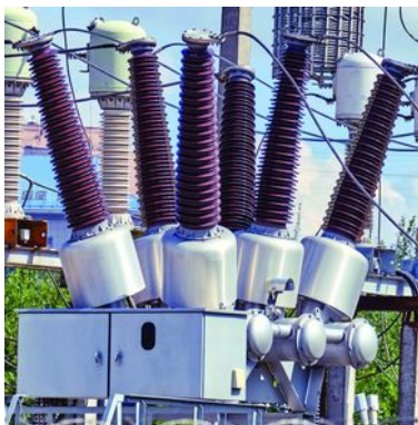
Interruptor de alta tensión en servicio, con las bornas y el mecanismo de operación donde se realizan las medidas del BPM.
