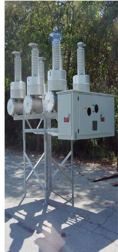
SWITCH- 72.5KV : Poids du SF6 : 13 kg
