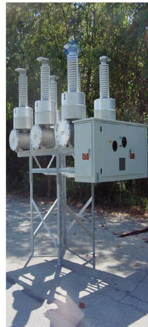
SWITCH- 72,5KV: Peso de SF6: 29lbs- 13kg
