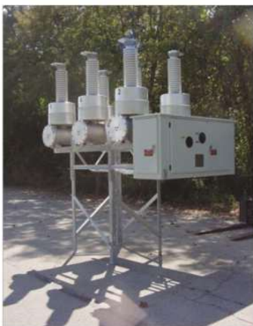
SWITCH- 72.5KV : Poids du SF6 : 13 kg
