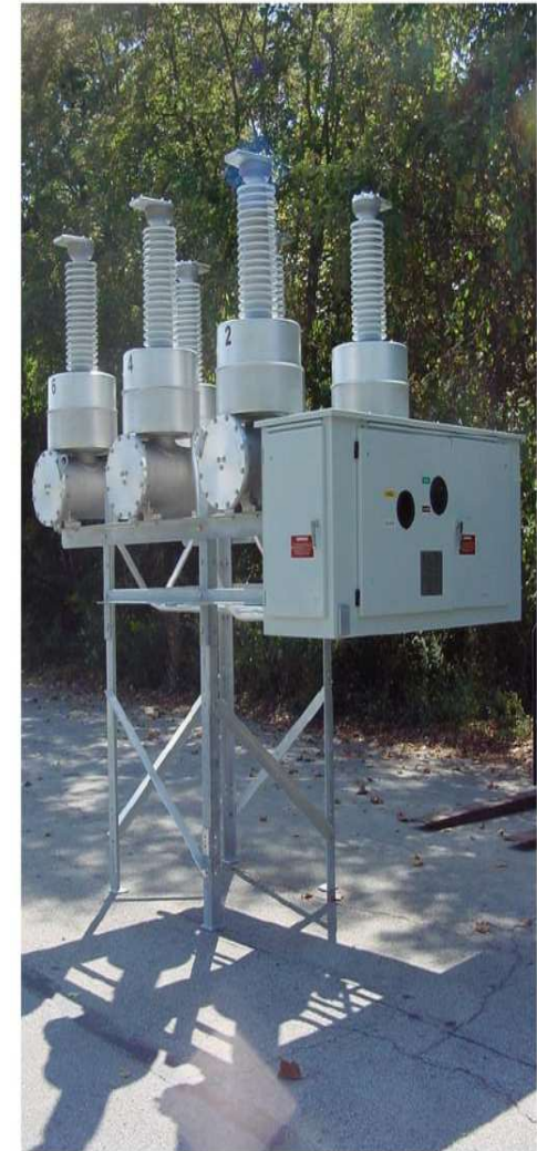
SWITCH- 72.5KV : Poids du SF6 : 13 kg
