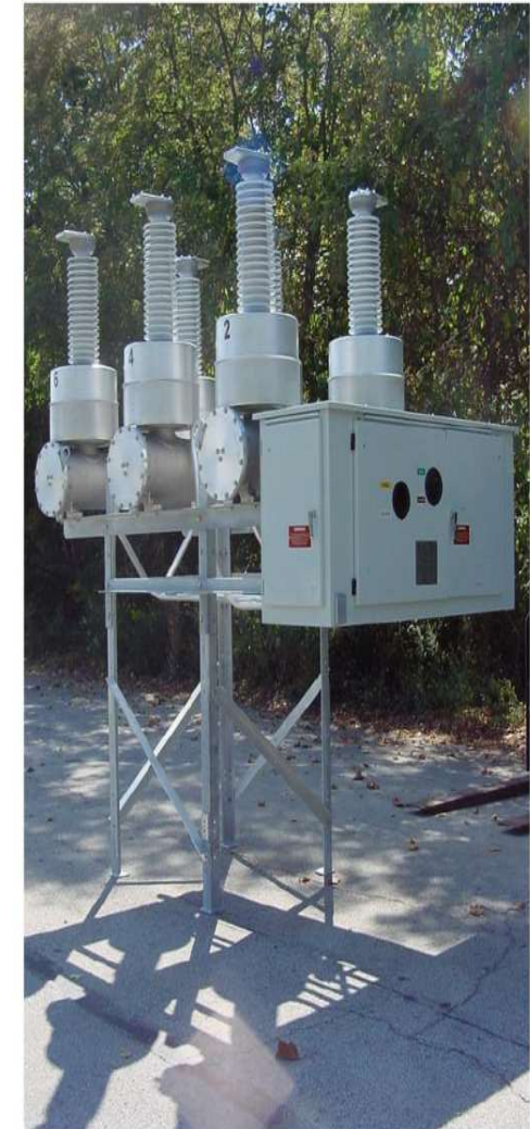
SWITCH- 72,5KV: Peso de SF6: 29lbs- 13kg
