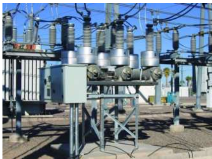
Interruptores de tanque muerto, una aplicación típica
