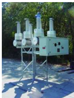
Servicio en campo sobre interruptores individuales
