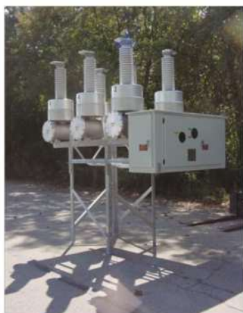
SWITCH- 72.5KV : Poids du SF6 : 13 kg
