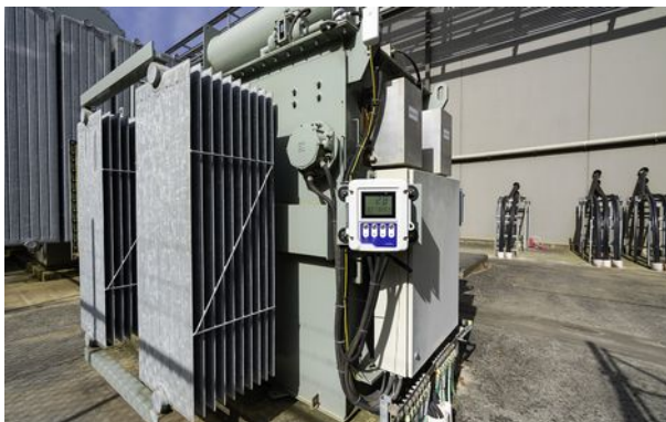
El B100 instalado en un transformador de distribución, calculando el punto caliente y el envejecimiento del papel aislante en tiempo real.
