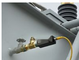
Sensor de hidrógeno instalado en la válvula de toma de muestras de aceite del transformador.
