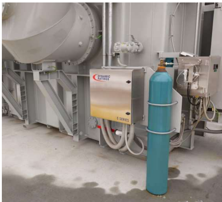
E Series instalado en un transformador de potencia
