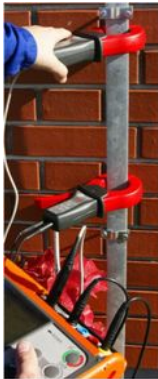
Medida con doble pinza sobre una pica de tierra, sin desconectar la instalación
