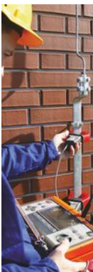
Método de doble pinza: resistencia de tierra sin desconectar la instalación
