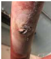
Caso real: DP localizada numa terminação de cabo
