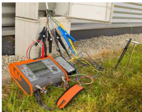
Medição de resistência de terra com o AMPI-525 no terreno
