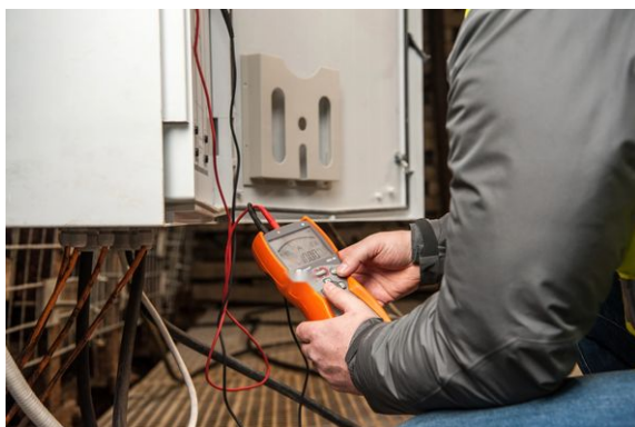
Ensaio de continuidade com o AMIC-30 num armário de distribuição
