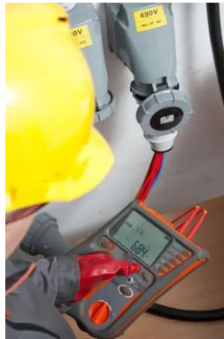
Medição de malha numa tomada industrial de 690 V com o AMZC-305
