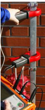
Método de pinça dupla: resistência de terra sem desligar a instalação
