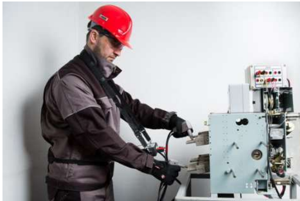
Medição de resistência de contactos num disjuntor na subestação
