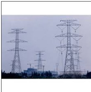
Subestações e redes de transporte.
