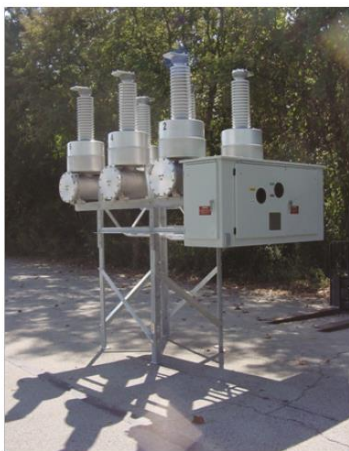
SWITCH- 72,5KV: Peso de SF6: 29lbs- 13kg
